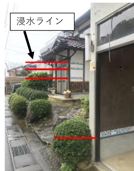
浸水の度に浸水地点を記録 されている。
