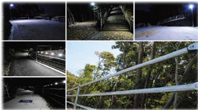
リードパイプ避難誘導灯
