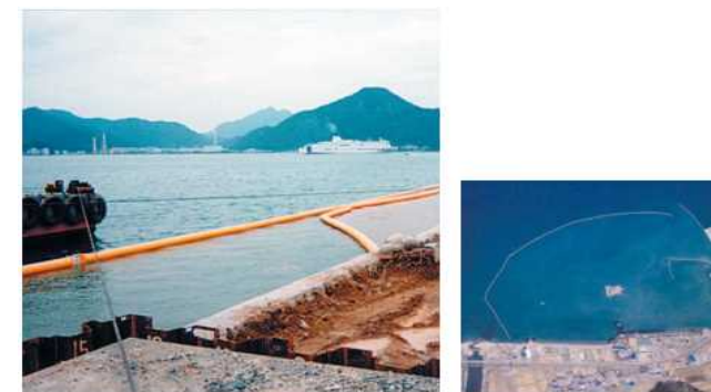
汚濁拡散防止フェンス
