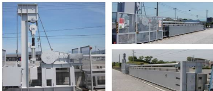
陸閘・水門等の自動閉鎖装置
