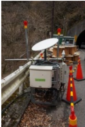
崩落地点に設置した簡易基地局
